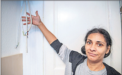
Ledninger hænger ned fra loftet.
